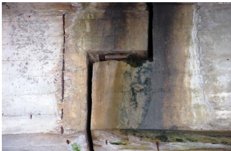
Vista dos dentes Gerber dos tabuleiros 03 e o tabuleiro bi apoiado (suspensão) 04 – lado Leste da OAE. Notar manchas de escoamento pela superfície das estruturas, bem como armaduras expostas e oxidadas pela face inferior.
