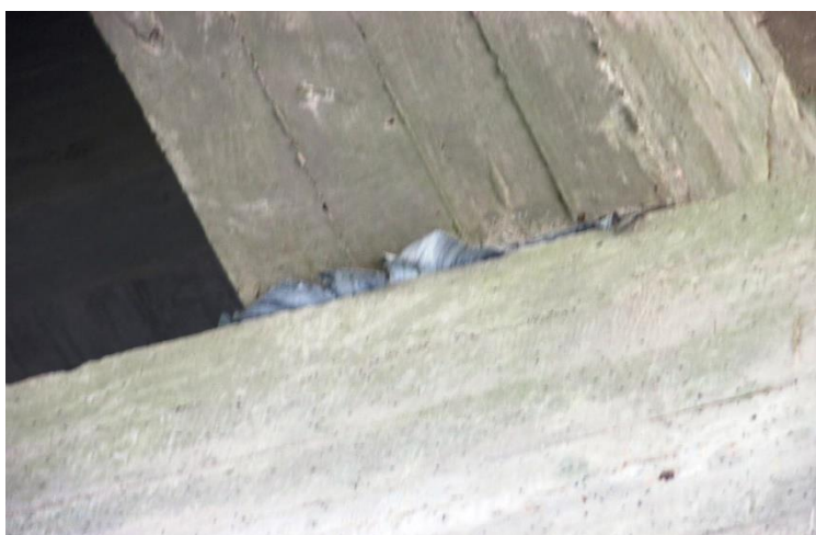
Idem foto anterior, porém, com enfoque ao aparelho de apoio (AA.20) totalmente degradado sobre a viga travessa da linha de apoio 07, sob a viga longarina VL.02.
