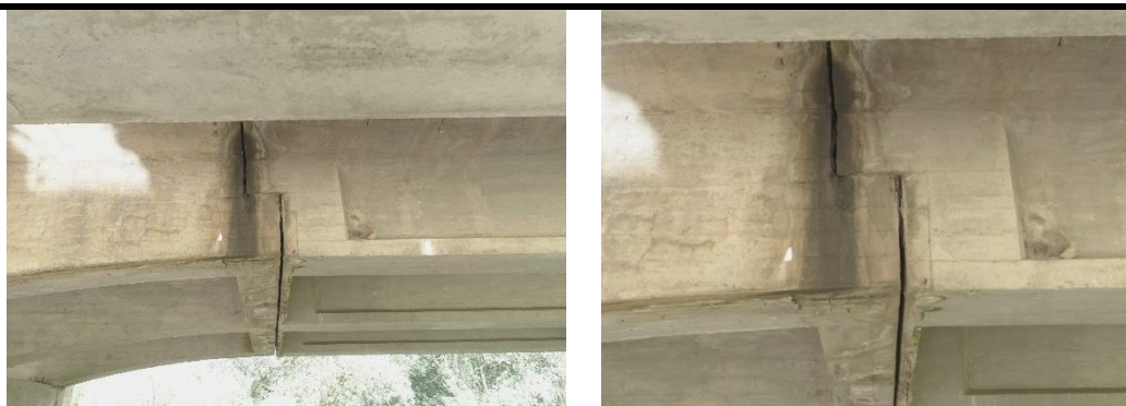
Patologia: aparelho de apoio placa de chumbo esmagado Solução: troca do aparelho de apoio
