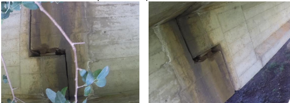
Patologia: roletes oxidados Solução: tratamento das peças oxidadas
