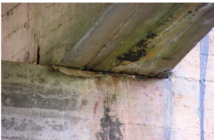
Vista do ao aparelho de apoio (AA.21) totalmente degradado sobre a viga travessa da linha de apoio 07, sob a viga longarina VL.03.
