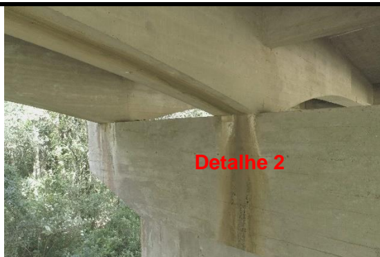
Patologia encontrada: esmagamento dos aparelhos de apoio Solução: troca de aparelho de apoio
