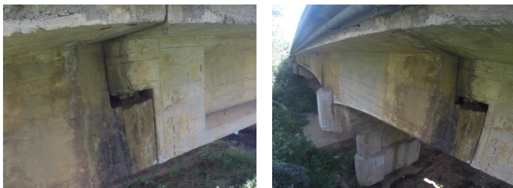
Patologia: roletes oxidados Solução: tratamento das peças oxidadas
