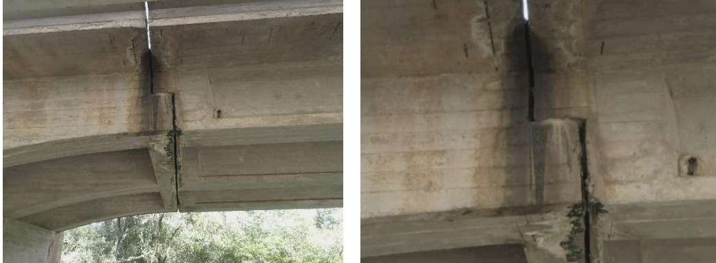
Dentes Gerber próximo ao apoio P7 – Lado esquerdo
