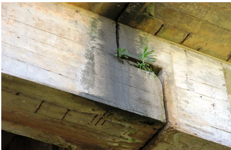
Enfoque de armaduras expostas e oxidadas pela face inferior da estrutura do dente Gerber junto à extremidade Sul do trecho em balanço do tabuleiro 05 – lado Oeste da OAE. Notar ainda, crescimento de vegetação entre os dentes.
