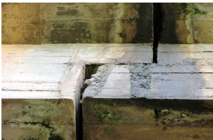
Vista dos dentes Gerber dos tabuleiros 05 e o tabuleiro bi apoiado (suspensão) 04 – lado Oeste da OAE, também com manchas de escurimento pela superfície das estruturas.
