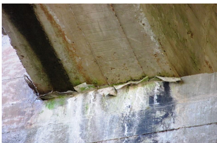
Enfoque da placa de chumbo deformada e com pontos de ruptura do aparelho de apoio (AA.15), locado sobre a viga travessa da linha de apoio 05, sob a viga longarina VL.03.
