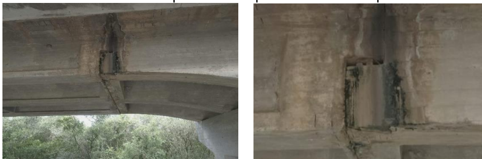
Dentes Gerber próximo ao apoio P6 – Lado esquerdo
