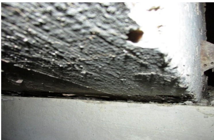
Idem foto anterior, com enfoque ao aparelho de apoio em neoprene (AA.23), com visão prejudicada, sobre a viga travessa da linha de apoio 08 e de base à viga longarina VL.02.
