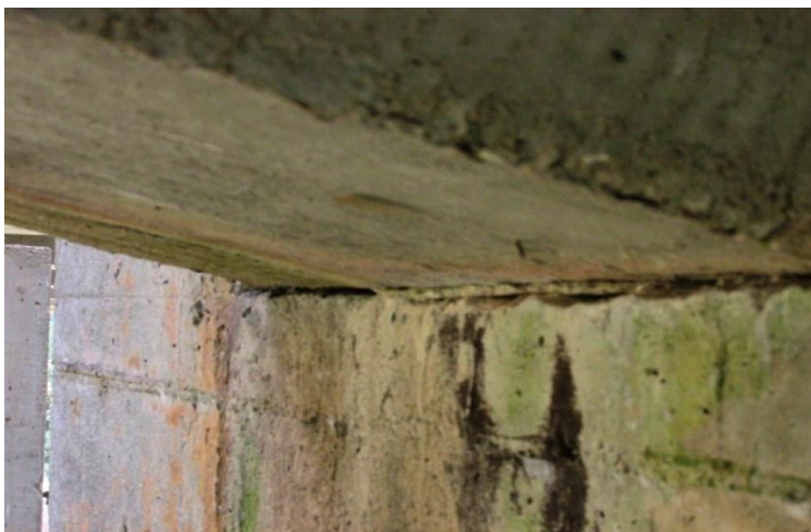
Enfoque do aparelho de apoio (AA.19), com a placa de chumbo deformada sobre a viga travessa da linha de apoio 07, sob a viga longarina VL.01.
