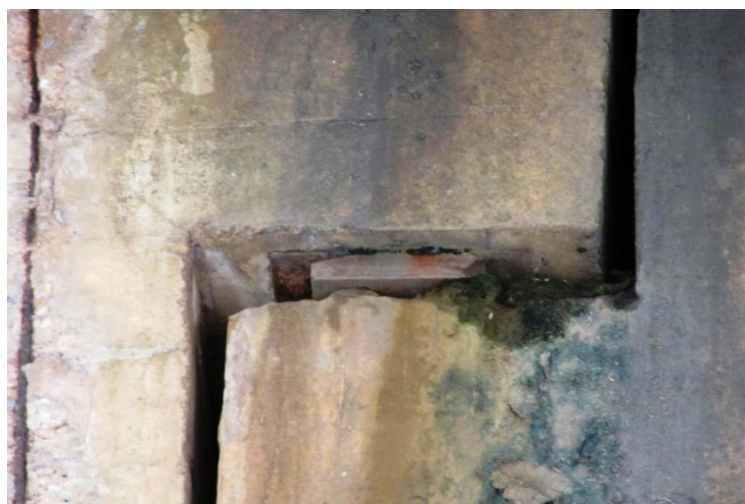
Idem foto anterior, em visão aproximada do aparelho de apoio móvel, com os elementos metálicos oxidados.
