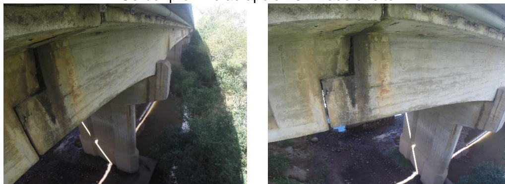
Patologia: aparelho de apoio placa de chumbo esmagado Solução: troca do aparelho de apoio
