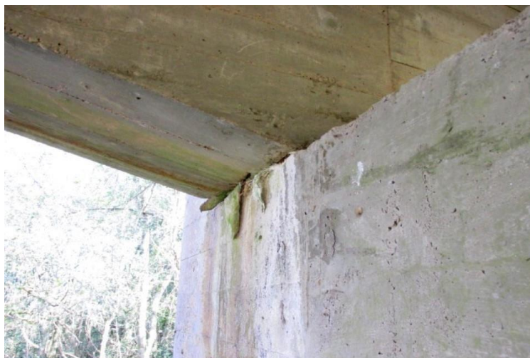
Vista do aparelho de apoio (AA.6), com a placa de chumbo totalmente deformada sobre a viga travessa da linha de apoio 02, sob a viga longarina VL.03.
