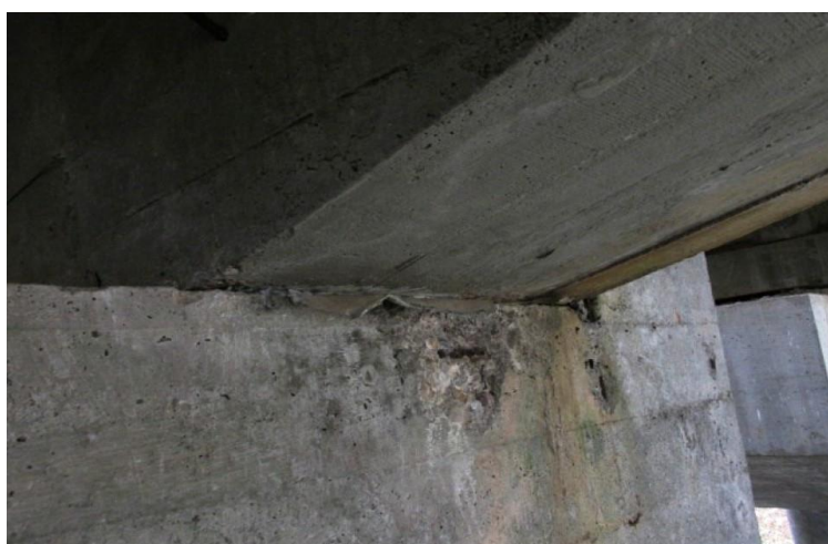
Enfoque ao aparelho de apoio (AA.4) locado sobre a viga travessa da linha de apoio 02, em articulação de chumbo, onde já se nota o total escoamento do material, constituindo em lâmina delgada, com perda de funcionalidade, porém, sem acarretar em indícios de vínculos inadequados (super x mesoestrutura).
