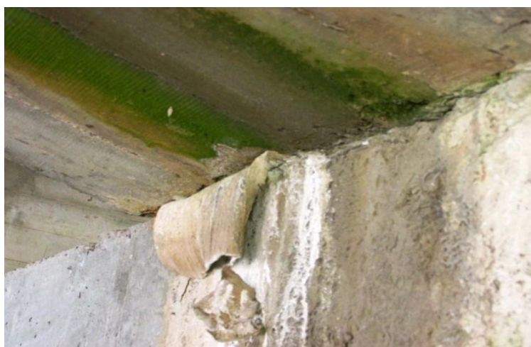
Idem foto anterior, porém, com enfoque ao aparelho de apoio (AA.5) totalmente degradado sobre a viga travessa da linha de apoio 02, sob a viga longitudinal VL.02.
