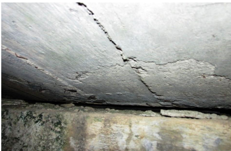
Enfoque do aparelho de apoio em neoprene (AA.22), em bom estado, locado sobre a viga travessa da linha de apoio 08, de base à viga longarina VL.01.
