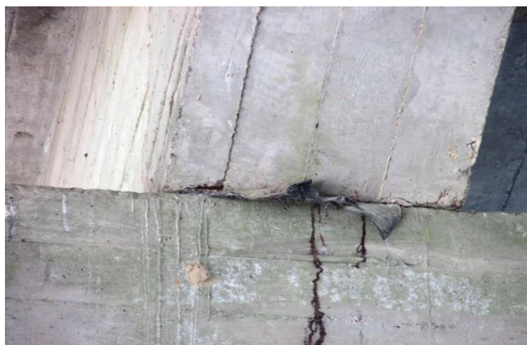
Idem foto anterior, em visão da placa de chumbo deformada do aparelho de apoio (AA.14), locado sobre a viga travessa da linha de apoio 05, sob a viga longarina VL.02.
