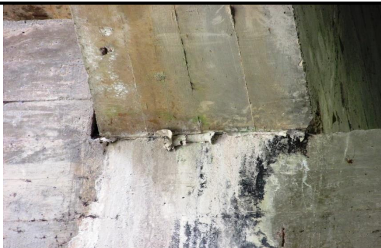
Vista do ao aparelho de apoio (AA.13) totalmente degradado sobre a viga travessa da linha de apoio 05, sob a viga longarina VL.01.
